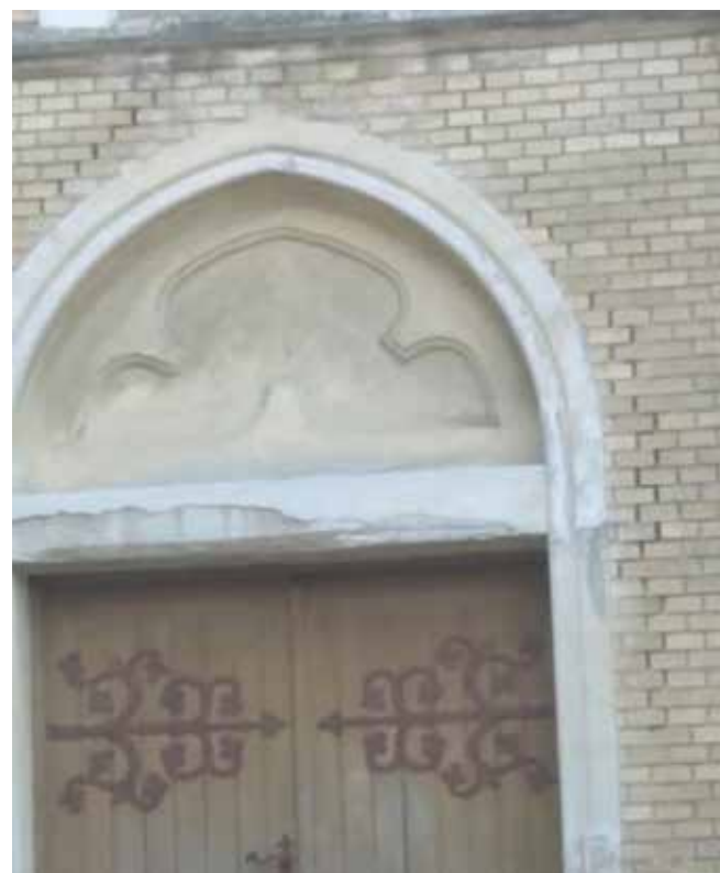
Repedések a falon a mellékajtó körül
