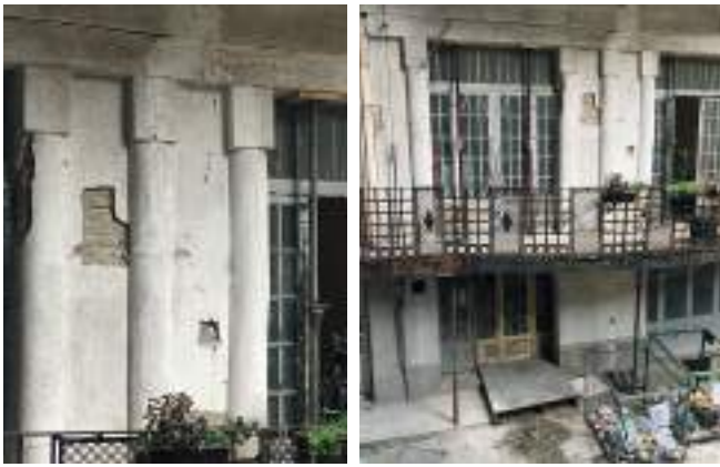
A sérült falszakasz a dúccokkal. A lebontott portásfülke elemeit a Politechnikai iskola vette gondozásba. Fotó - Dubicsánác Kornél, G24 osztály
