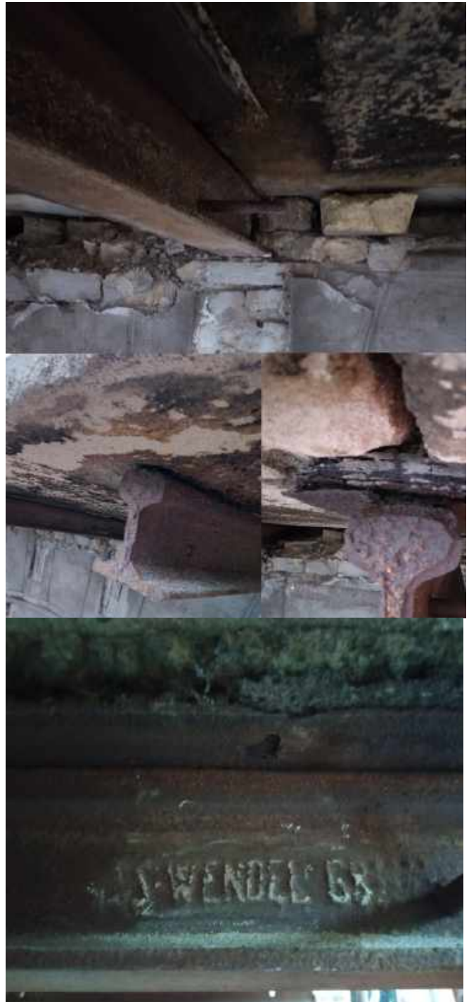
A stilizált gyámköveket alatt láthatók a konzolosan túlnyúló vasúti sínek. Ezek viselik az erkény terhét.
